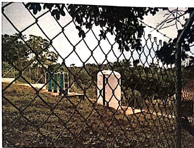
Aspecto del sistema de acueducto de Sohaibado
